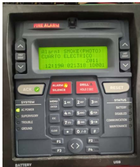
En este ejemplo, el panel de control inteligente central indica que la alarma fue causada por detección de humo en cuarto eléctrico.
