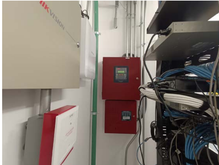
Ubicación del Panel de control inteligente central de la alarma.
